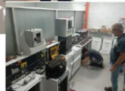
Coupe électrique – vérification annuelle
