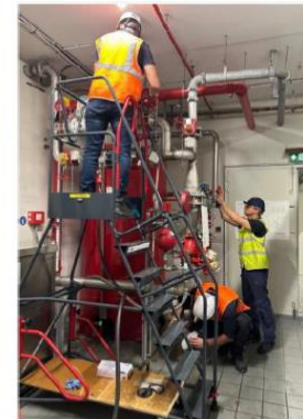
Vérification émulseur anti-incendie
